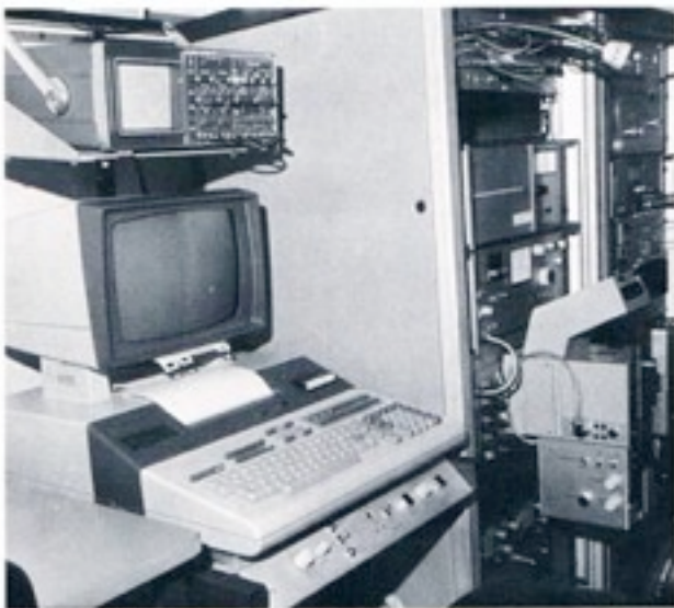
Echo-Log-Übertageausrüstung mit computergesteuertem Meß- und Datenerfassungssystem Echo-log surface equipment with computerized data acquisition system
